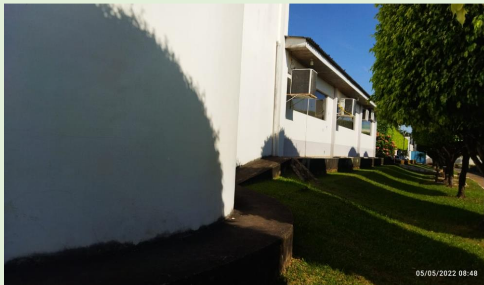
Aplicação de grafiato na parte do Plenarinho - Pintura de toda parede externa e calçada (Foto lado Fórum)
