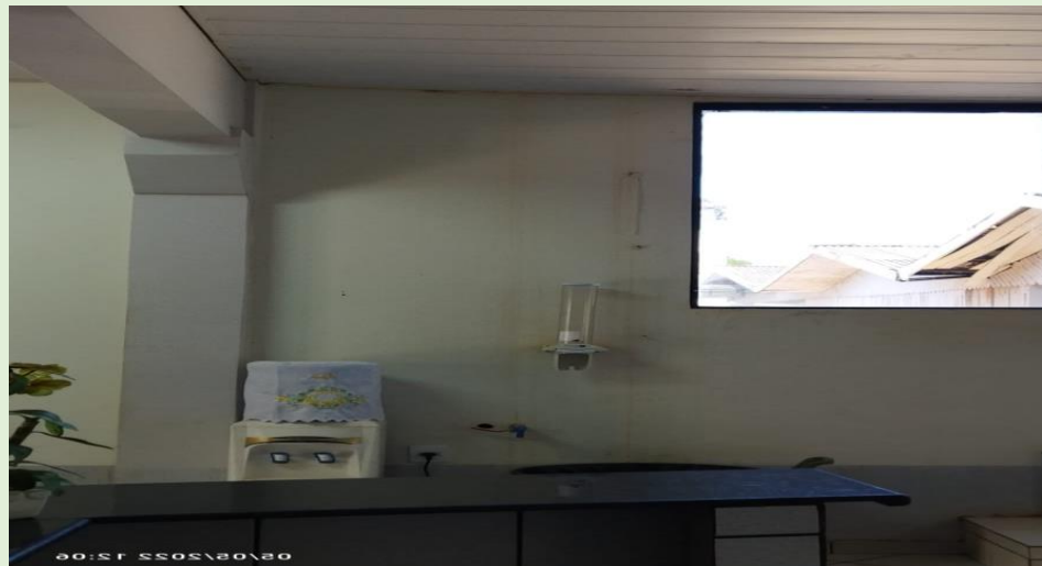
Parede ao do lado do bebedouro com sinais fortes de escoamento de água
